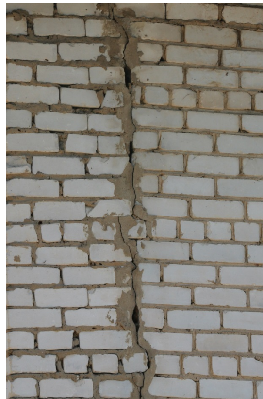
Повреждение вертикального стыка стен каменного здания
